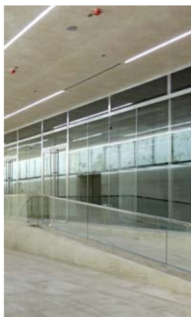
Cloison coupe-feu EI30 – Mercury Tower, Moscou, Russie
