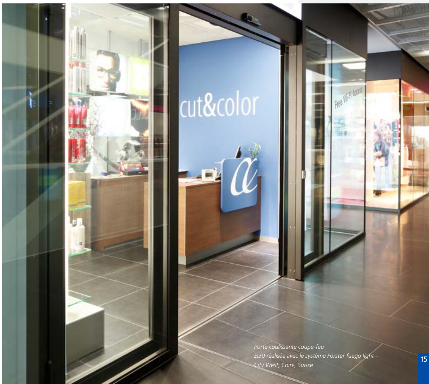
Cloisons coupe-feu EI30 et EI60 / portes coulissantes coupe-feu automatiques EI30, IKEA, Saint-Gall, Suisse
